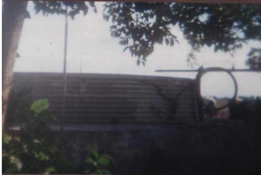
Tanque de agua u caño aéreo, por precaución revestido interiormente con loseta
